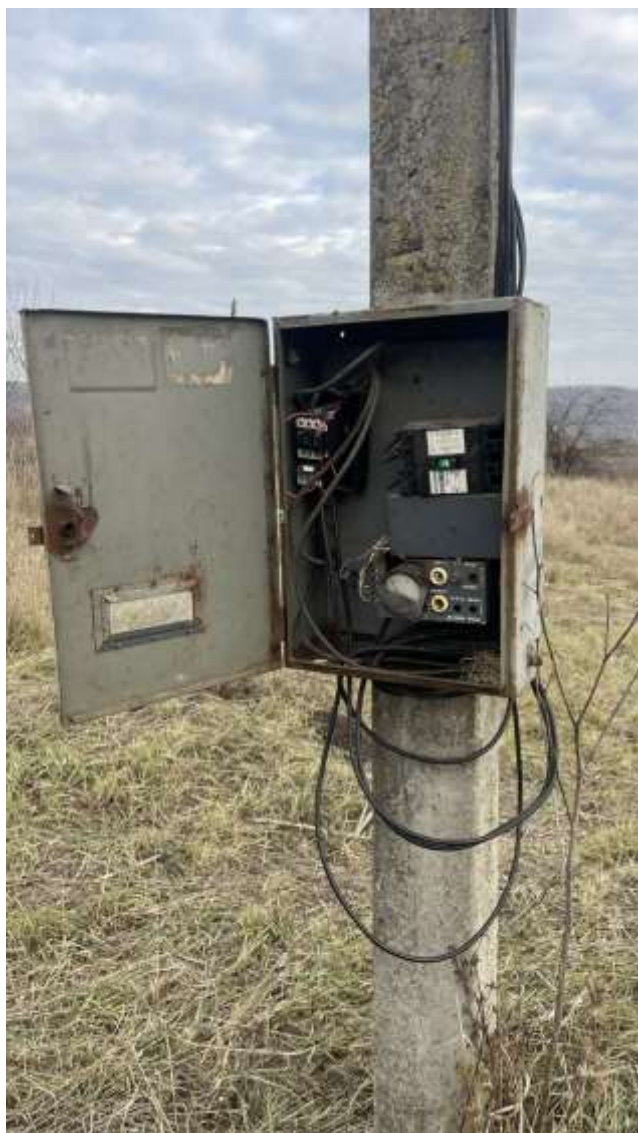
Panoul de comandă și control al pompei submersibile
