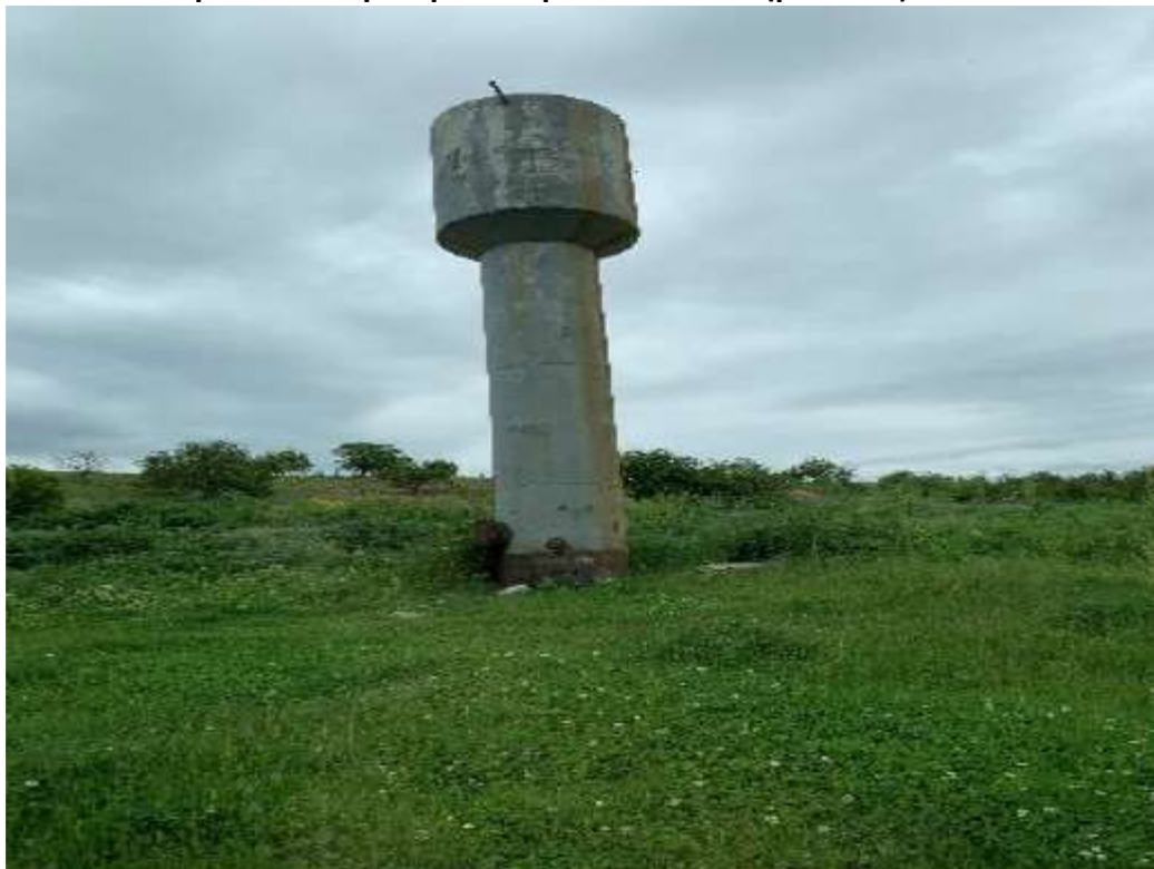
Castelul de apă unde se pompează apa de la sondă (pe același teritoriu cu sonda nr. 3894)
